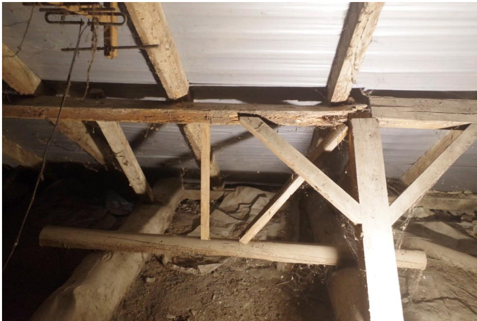
31. Padlástér a keleti épületrész felett, az északi derékszelemen sérült része
